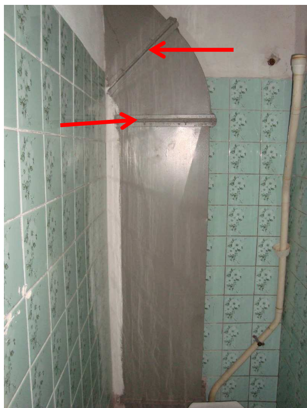
Foto č. 3 - Objekt č. 116 - ubytovna, část A, 1.NP. Svislé odvětrávací potrubí na WC. Azbestové těsnící šňůry v přírubách potrubí.
