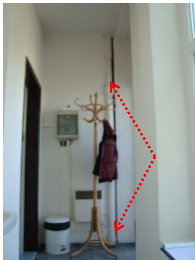
Foto č. 7 - Objekt č. 79 - věž letové kontroly, 3.NP, chodba. Odvětrání kanalizační stoupačky sestavené pravděpodobně z azbestocementových rour.
