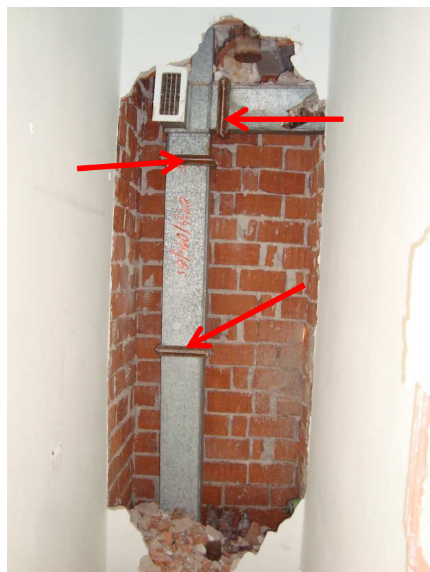
Foto č. 4 - Objekt č. 116 - ubytovna, část B, 2.NP. Svislé a vodorovné odvětrávací potrubí v šachtě. Azbestové těsnící šňůry v přírubách potrubí.
